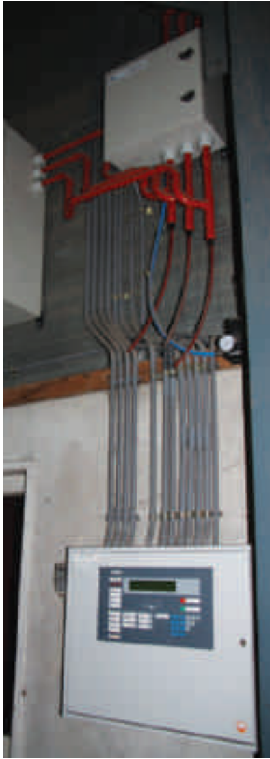
De brandmeldinstallatie is een geavanceerd systeem, dat afgestemd is op het productieproces.
